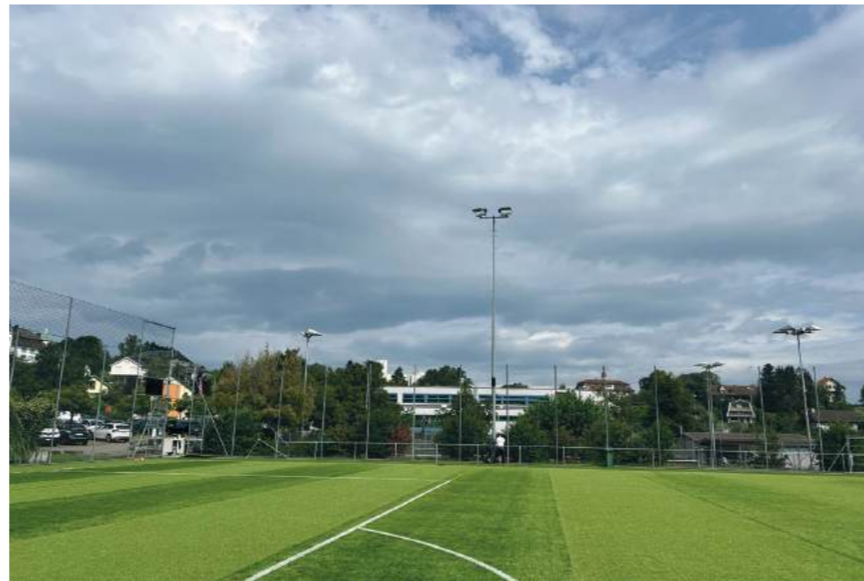
Bestehende Kandelaber mit neuen Leuchtkörpern
