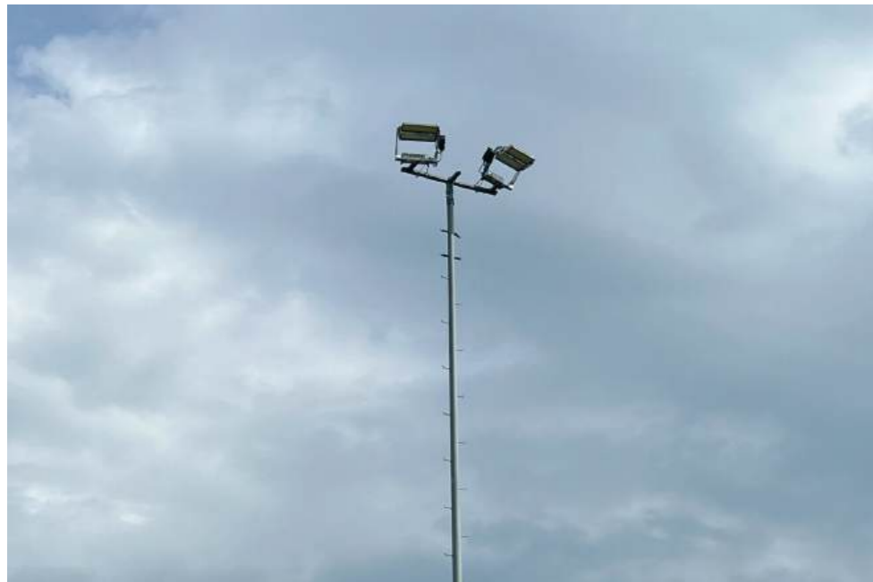
Bestehende Kandelaber mit neuen Leuchtkörpern
